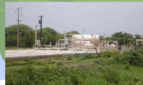
Station de collecte et d'épuration de Kabor
